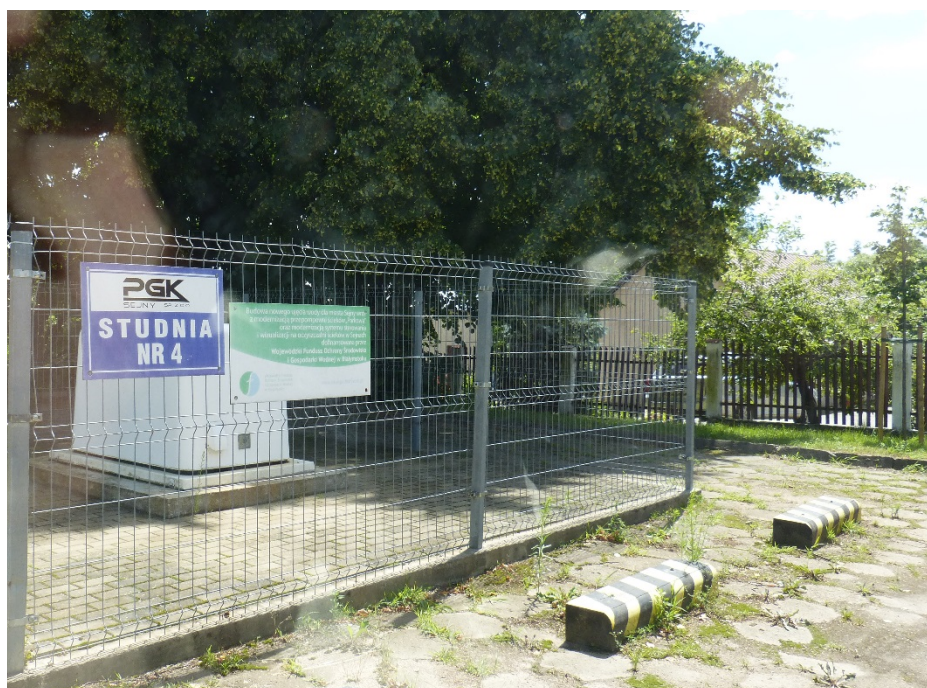
Fot. 5 Czynne ujęcie wody wraz ze strefą ochronną
